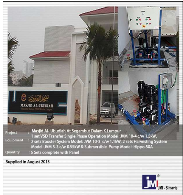
Year 2015- Transfer, VSD, SPO & Submersible (5 sets) At Masjid Al-Ubudiah Segambut Dalam K. Lumpur
